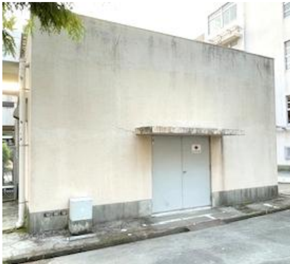
高圧受電設備
